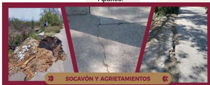
Gráfico. Socavón y agrietamiento en vialidades principales de Apaxco.
